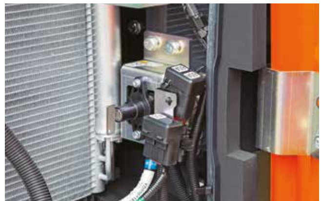
Az akkumulátorleválasztó kapcsolónak köszönhetően a karbantartás biztonságosan elvégezhető.
